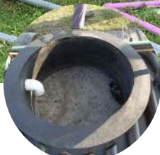
Reactor 1 MBBR. Reactor para remoción de materia orgánica
