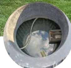
Sedimentador Lamelar. Separación de sólidos
