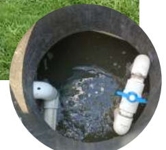
Sistema de desinfección. Reactor para desinfectar mediante ozono
