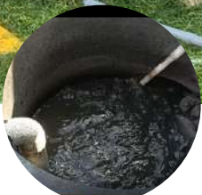
Sistema anóxico. Reactor para pre-destrificación
